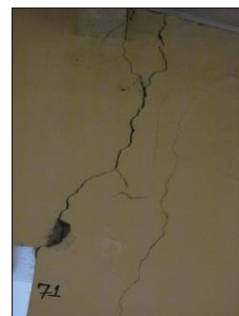
Gebäudeschäden durch Erdbeben in Monterredondo
